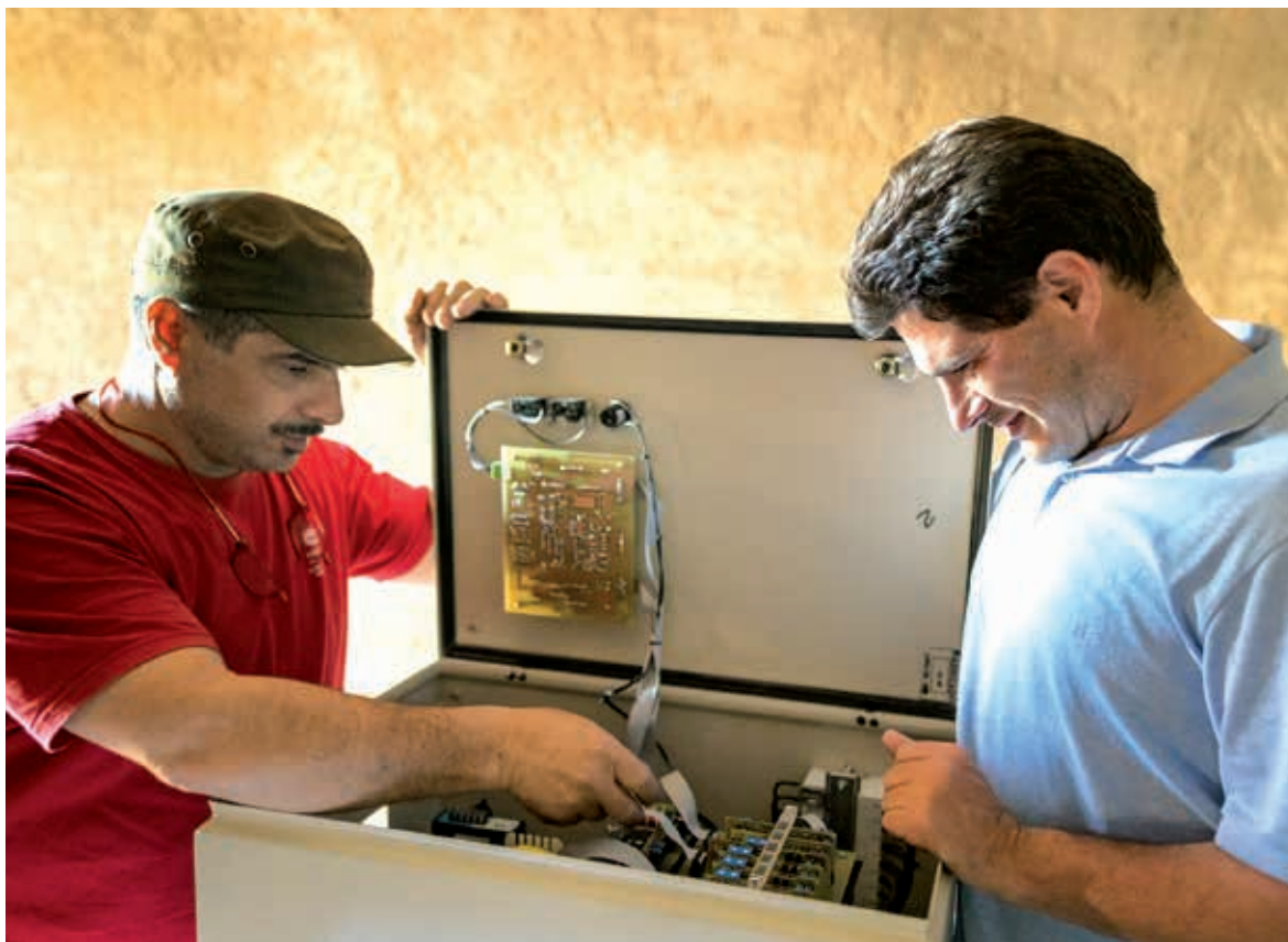
Padre Lucas (rechts) und sein Bruder Ricardo Galante (links) kontrollieren die Solaranlage im Bergdorf La Hoyada.
